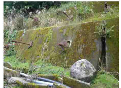
写真 1 アンカーの飛び出し状況
