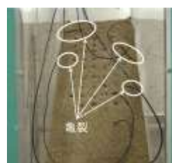
写真-3 複数の亀裂
