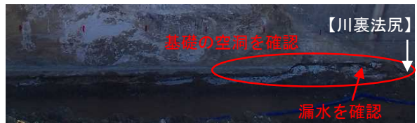
写真-2 函体下面の空洞化 (川裏下流側)
