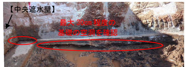
写真-1 函体下面の空洞化 (川表上流側)
