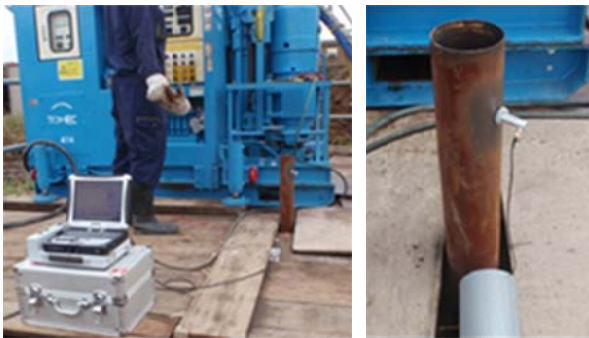
図-2 管理装置および受信センサー取付け状況
