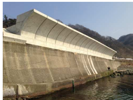
写真1 鼠ヶ関地区上部フレア護岸
