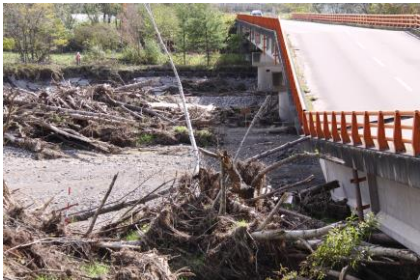
写真 1 橋梁周辺に堆積した大量の樹木
