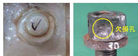
写真-3 ねじ谷部の欠損(腐食レベル 3)
