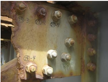
写真-1 対象橋りょうの腐食状況
