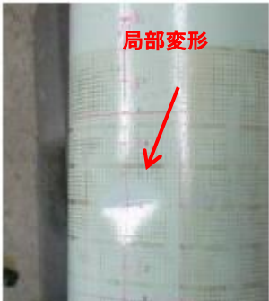
図－1 局部変形のある鋼管 （管径 400mm）
