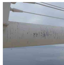
写真 1 塗膜割れの状況
