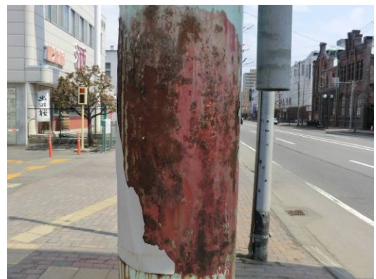
図-2 橋脚の腐食状況
