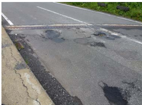
写真-1 ジョイント付近のポットホール
