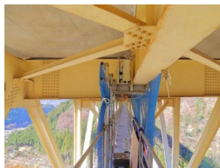
図-6 実橋梁の縦桁下フランジに設置した TMG
