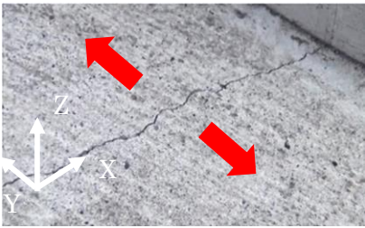
写真-2 土間コンクリートのクラック
