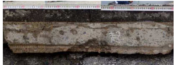
図-1 RC 床版の内部水平ひび割れの事例
