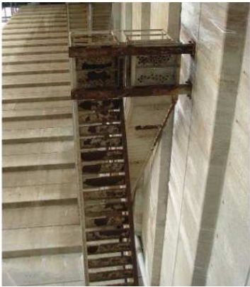
写真 1 腐食した管理路 (下から撮影)
