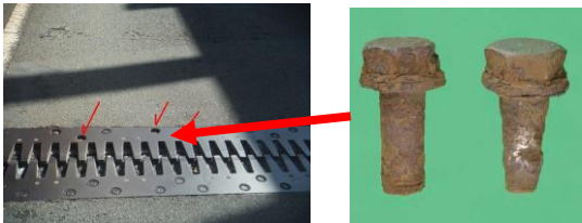
図-2 鋼製伸縮装置取付ボルトの破断例
