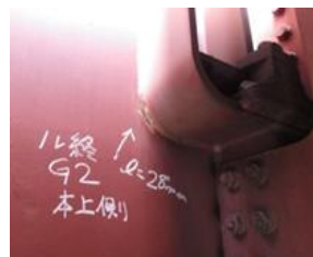
写真-1 主桁腹板切欠き部損傷
