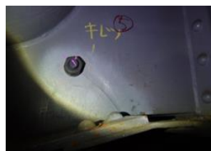
写真-2 横桁腹板切欠き部損傷
