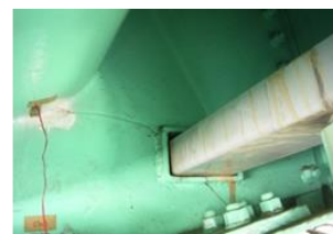
写真-3 横桁腹板切欠き部損傷
