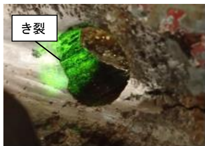
写真-3 孔縁のき裂（桁外側から撮影）
