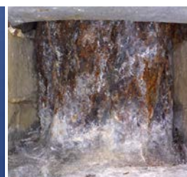
写 3 ソケット部状態
