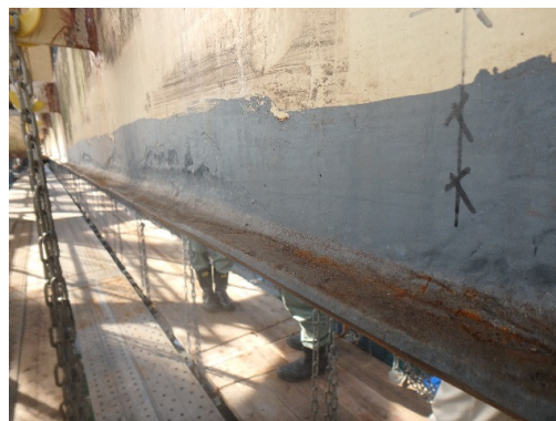
図-1 トラス橋下弦材の腐食状況
