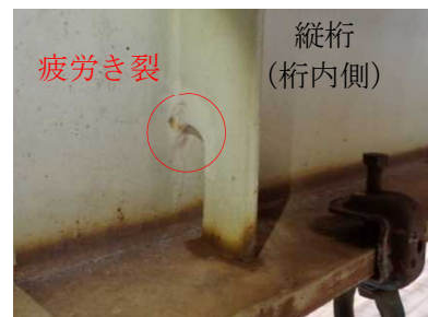
写真-1 縦桁補剛材下端のき裂
