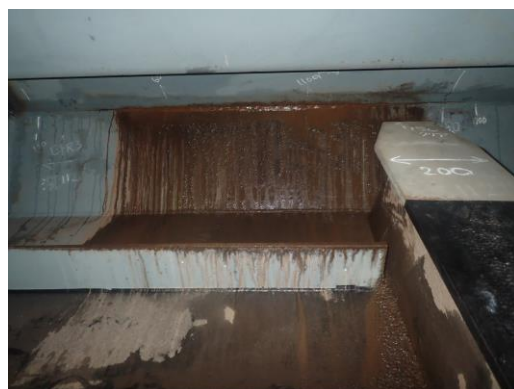
写真-1 鋼箱桁内面コーナープレート部の損傷
