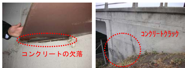
写真-1 桁埋め込み方式の損傷事例
