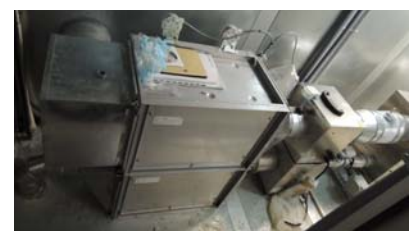
写真-6 塔・桁内乾燥送気設備
