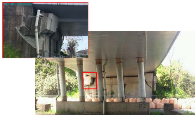
図-2 ロッキング橋脚の傾斜及び横変位拘束構造の損傷
