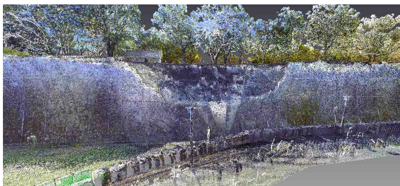
(b) 百間石垣の崩壊部
