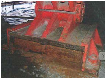
写真-1 ローラー部の腐食
