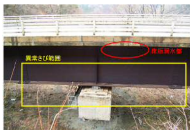
写真1 下フランジの腐食の事例 2)
