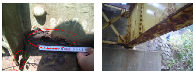
写真-1 A 橋りょう腐食状況 写真-2 B 橋りょう腐食状況
