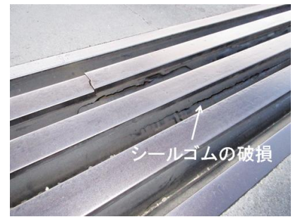
図3 シールゴムの劣化と破断
