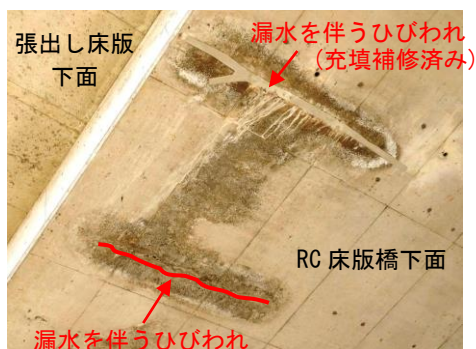
写真-1 RC 床版橋主桁下面の漏水を伴うひびわれ
