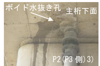
写真-3 水抜き孔からの水の流出
