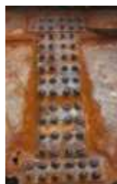
写真1. 腐食した摩擦接合継手
