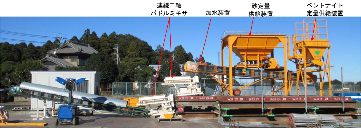
図-1 ベントナイト混合土システムの全景（最適化されたシステム）
