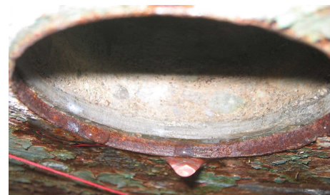
写真-2 撤去孔からの漏水状況
