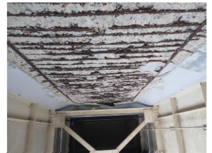
写真-1 剥落状況
