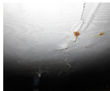
写真－６ 錆汁の発生
