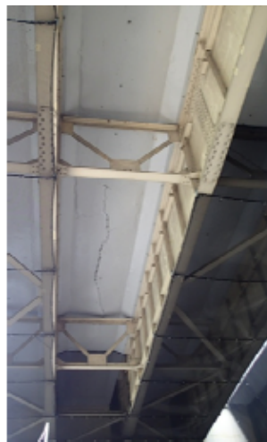
写真－1 ひび割れ発見
