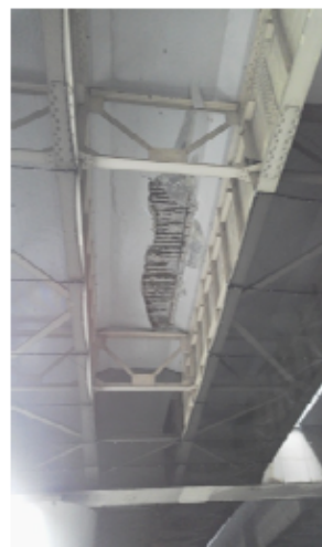
写真－2 剥落発生
