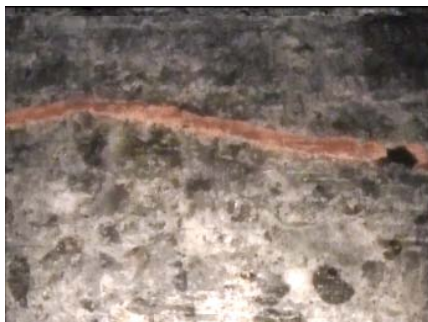
写真 5 水平ひび割れ状況
