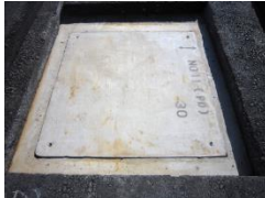
写真 6 状態模擬例 No.13 水平クラック
