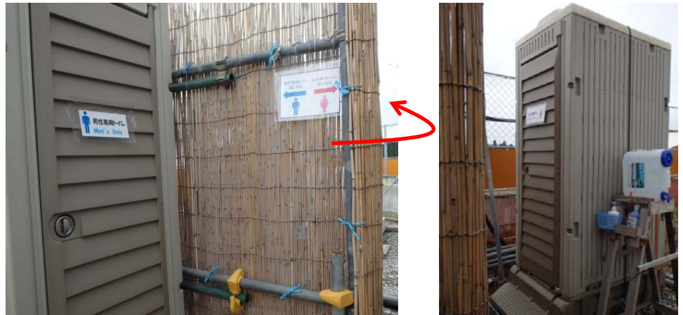
写真-4 屋外仮設トイレの目隠しと女性専用トイレの設置
