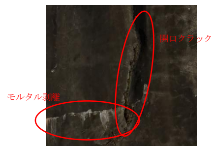
図7 空撮画像吹付斜面劣化部(抜粋)
