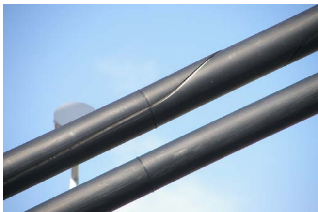
写真－1 斜材保護管の損傷例
