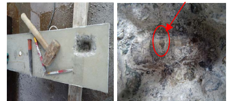
写真-2 はつりによる鉄筋腐食確認
