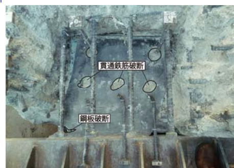
写真 3 孔あき鋼板破壊状況
