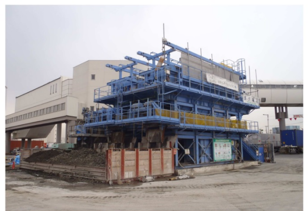
写真-1 排泥処理プラント全景
