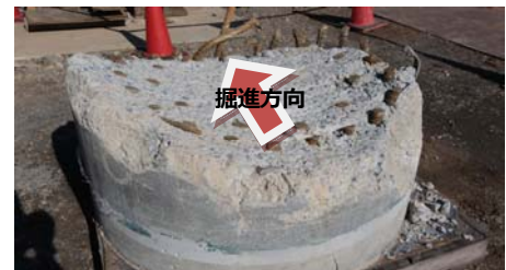
写真-2 RC杭切削実験後の状況
