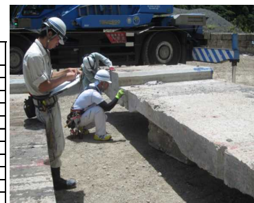
図 4 目視確認状況
