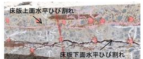
写真 1 切断面におけるひび割れ状況
