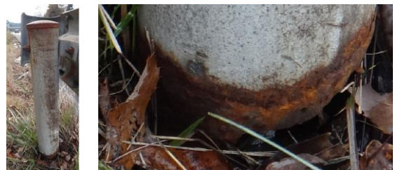
図 2 著しい腐食が生じたガードレール支柱の外観 外径 140 mm のガードレール支柱
