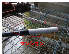
写真-5 ケーブルマンション部
