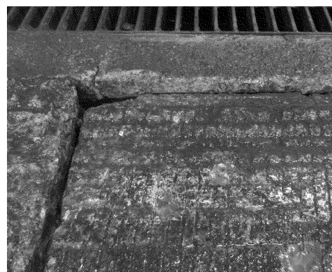
写真-2 舗装版沈下状況
