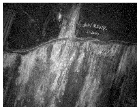
写真-1 第 I 世代覆工変状状況
